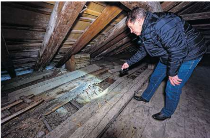
Die Unterseite der Bretter über den Zimmern des Obergeschosses sind stellenweise bemalt. Das verzögert die Sanierungsarbeiten.
